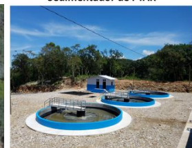
Sedimentador de PTAR
